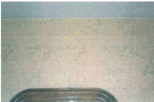
Fissuration intérieure, tapisserie déchirée - Maison André.
